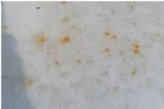
Korrosionsschäden wegen zu geringer Schichtdicke
